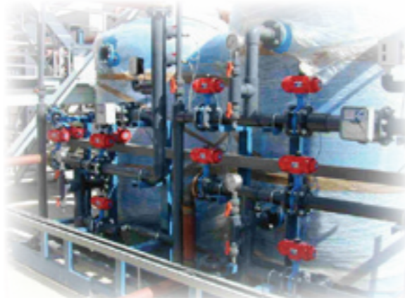
Tratamiento de purines (Lérida, España) Liquid manure treatment plant (Lérida, Spain)
