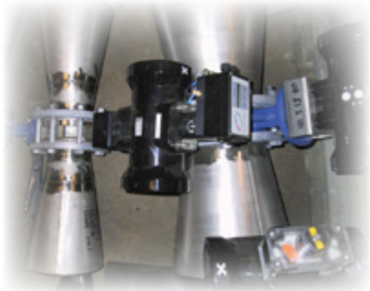
Central eléctrica (Finlandia) Power plant (Finland)
