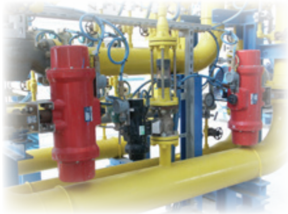
Planta de ciclo combinado (Cartagena, España) Combined cycle cogeneration plant (Cartagena, Spain)
