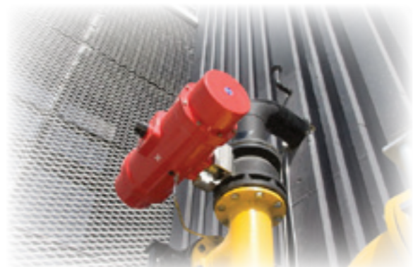
Sistema de Climatización (Expo Zaragoza, España) Heating & Cooling (Expo Zaragoza, Spain)
